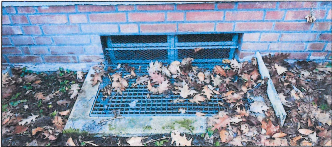
Abb. 6: verschlossenes und mit Hasendraht gesichertes Kellerfenster.
