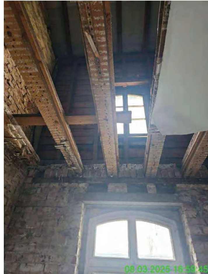
Westflügel: Verfaulte Deckenbalken wg. Hausschwammbefall
