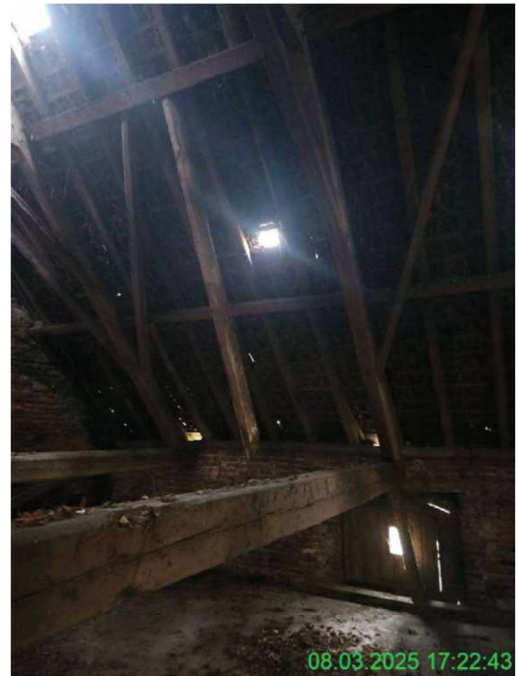
Ostflügel: Herunterhängender Dachstuhl durch Fäulnis. Standsicherheit gefährdet.
