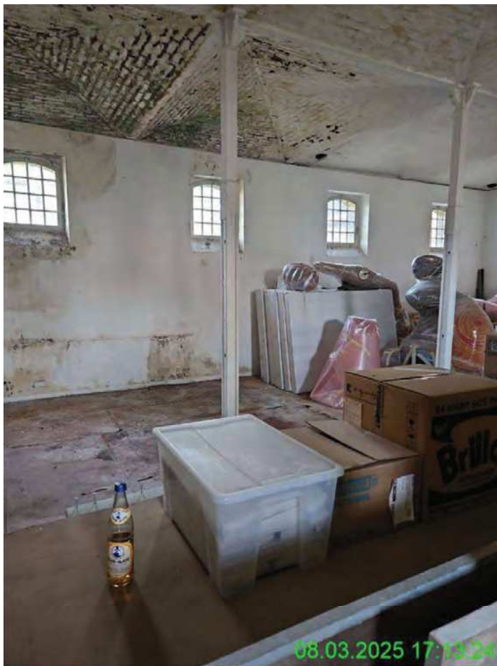
Ostflügel: EG ebenfalls stark geschimmelt durch Wasser-Eintritt.
