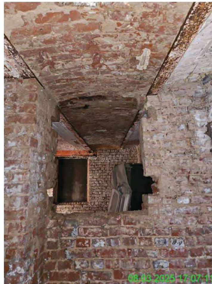
Südflügel: korrodierte Stahlträger im EG wg. Wasserbefall Kellerbereich stark einsturzfähig, weil die Träger der Kappendecke massiv korrodiert sind (Kein Bild).
