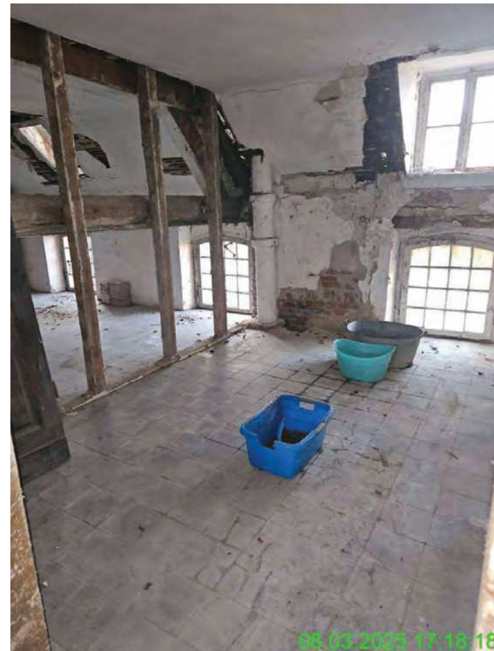
Ostflügel: Gegenüberliegende Seite, teilweise gleiches Bild. Obergeschoss statisch bedingt nicht betretbar. Eventuell auch Holzschwammverdacht
