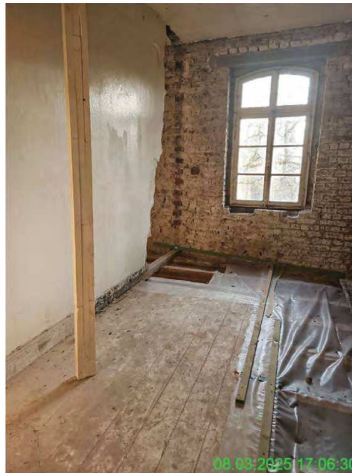
Westflügel: Bereits behandelter Hausschwammbefall.
