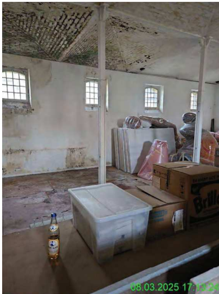
Ostflügel: EG ebenfalls stark geschimmelt durch Wasser-Eintritt.
