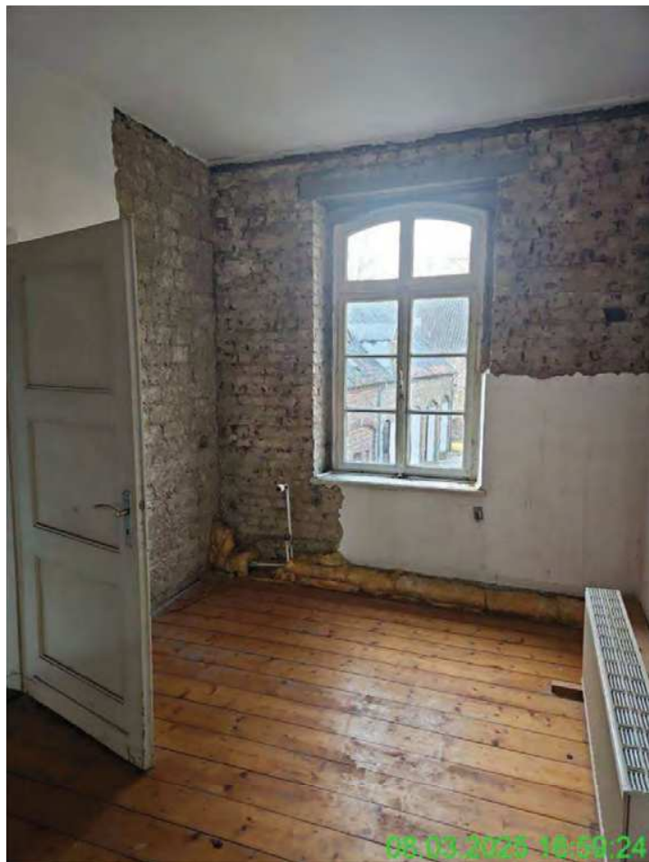
Westflügel: Entfernter Putz, Injektoren wegen Haus-Schwammbefall
