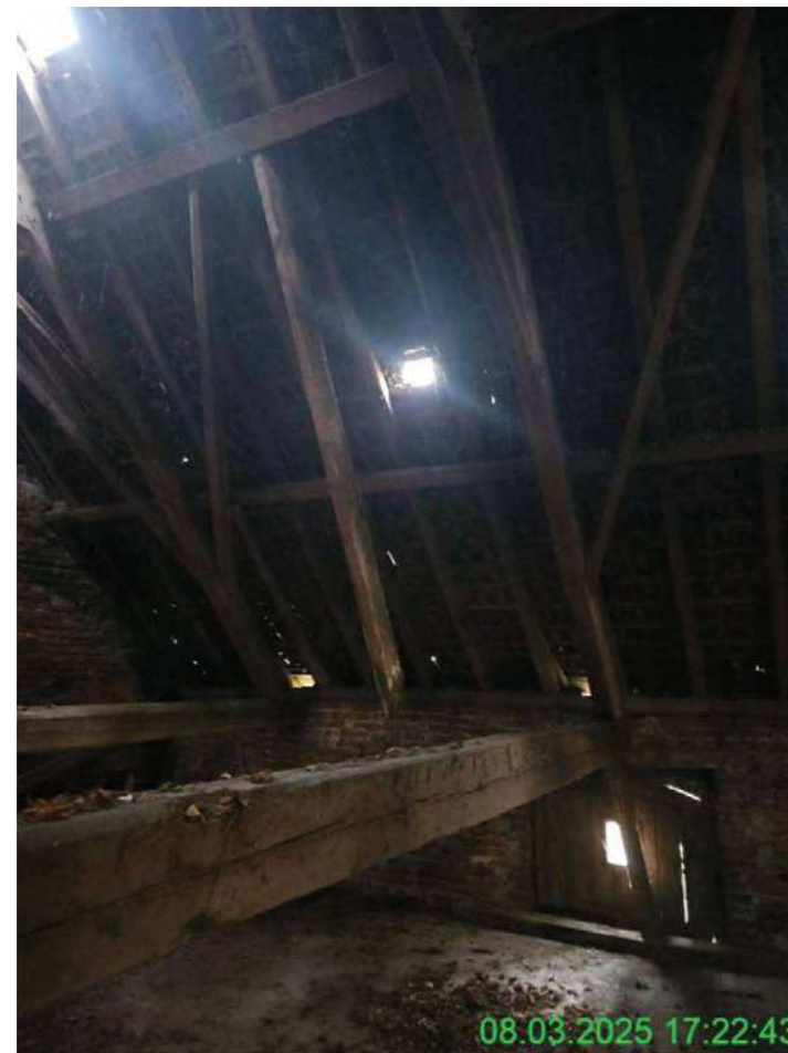
Ostflügel: Herunterhängender Dachstuhl durch Fäulnis. Standsicherheit gefährdet.
