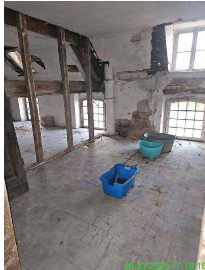
Ostflügel: Gegenüberliegende Seite, teilweise gleiches Bild. Obergeschoss statisch bedingt nicht betretbar. Eventuell auch Holzschwammverdacht
