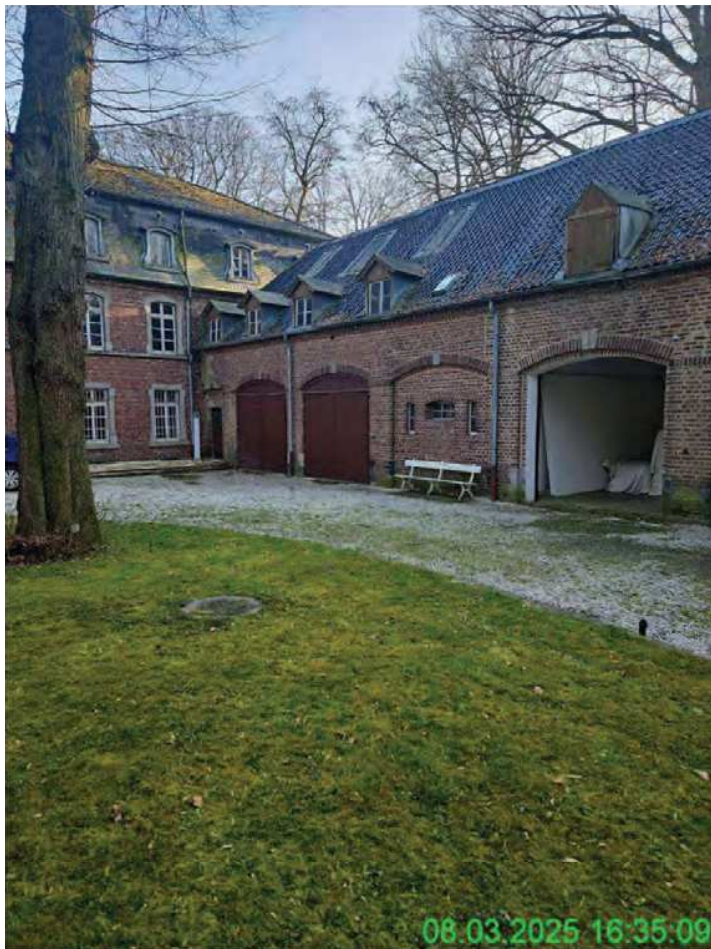
Südflügel: OG nicht betretbar. Einsturzgefährdet. Massive Wassereintritte.
