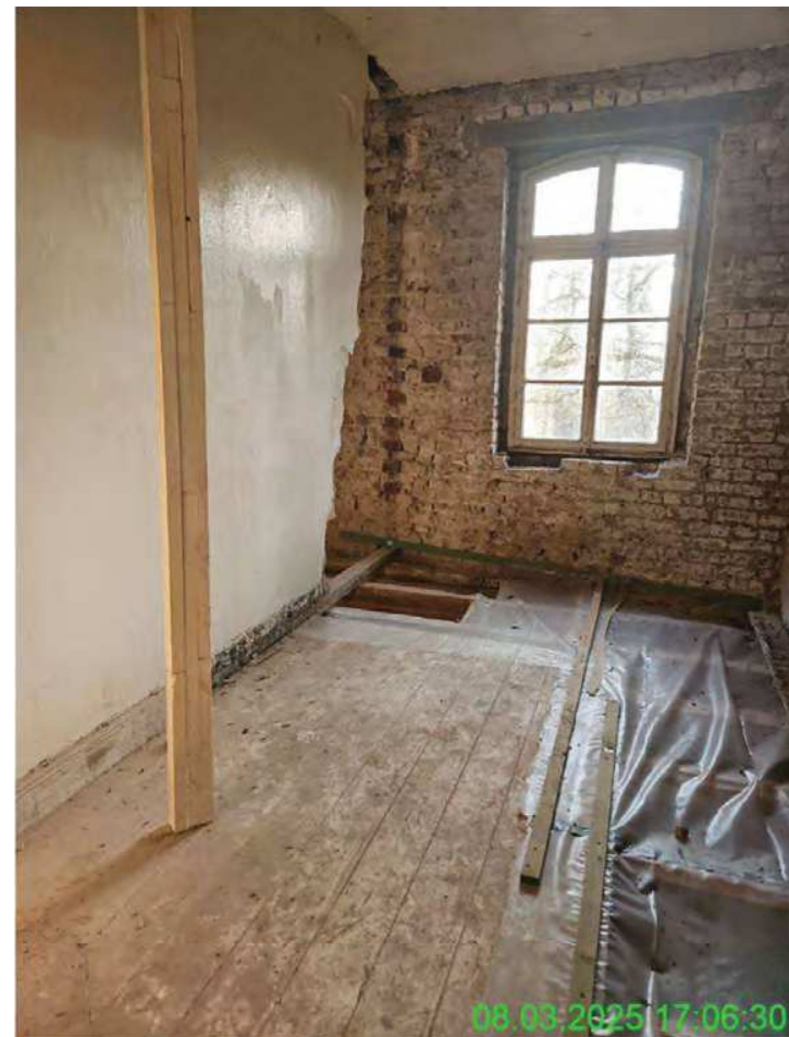
Westflügel: Bereits behandelter Hausschwammbefall.
