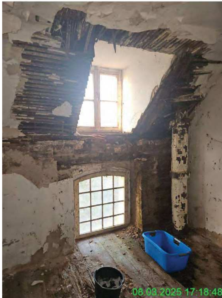
Ostflügel: Massive Fäulnis. Holzsturz über Fenster Schon komplett weg gefault. Sims droht abzurutschen. Dachstuhl komplett gefault. Holzschwammverdacht.
