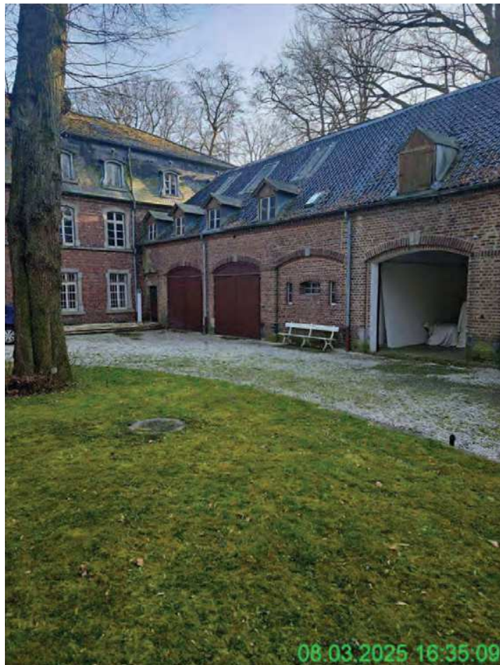
Südflügel: OG nicht betretbar. Einsturzgefährdet. Massive Wassereintritte.
