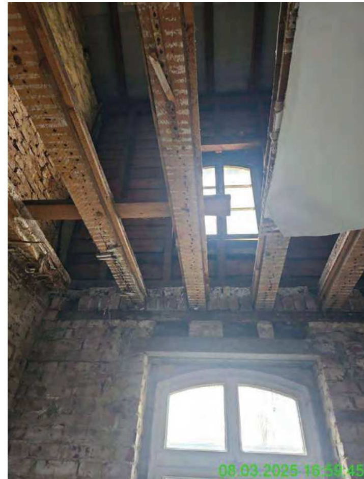
Westflügel: Verfaulte Deckenbalken wg. Hausschwammbefall
