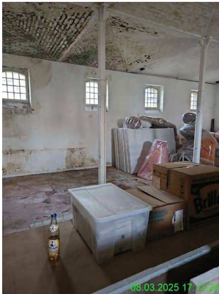
Ostflügel: EG ebenfalls stark geschimmelt durch Wassereintritt.
