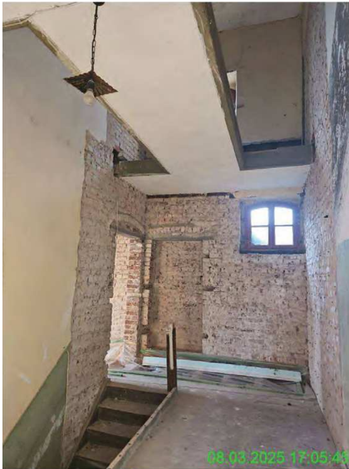
Westflügel: Entfernte Holztreppen wg. Hausschwammbefall
