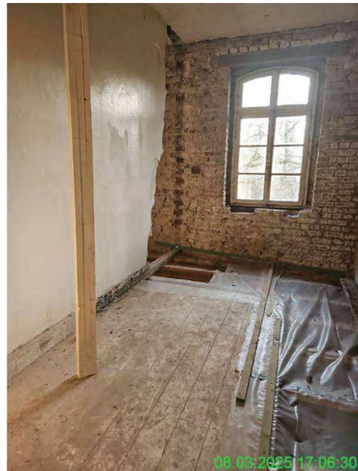
Westflügel: Bereits behandelter Hausschwammbefall.
