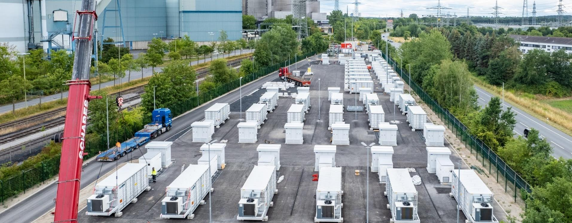
Baufindliche Batteriespeicheranlage - Gersteinwerk
